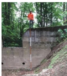
Messlatte unteres Retentionsbecken Leiding
