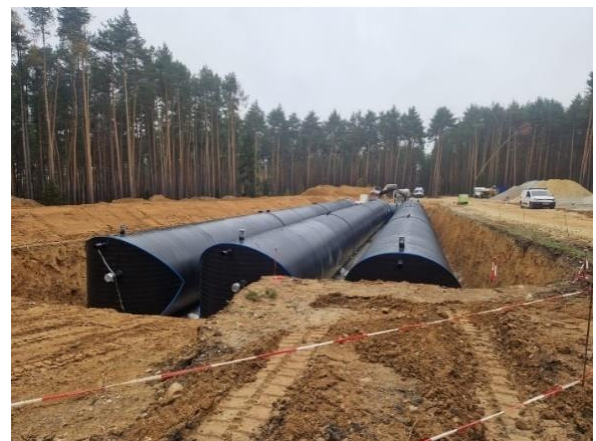
Hochbehälter mit drei Rohren
