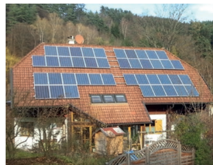
Photovoltaikanlage der Fam. Maier in Haßbach
